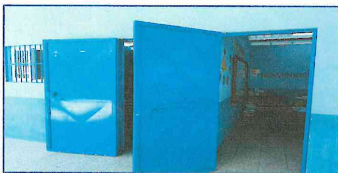
Foto 1: El abatimiento de la puerta del salón de 1ero. A 3ro. Obstaculiza el ingreso al aula de párvulos.
