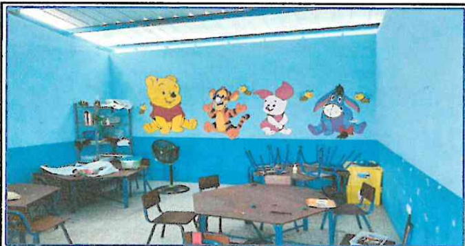
Foto 3: El aula de párvulos no cuenta con la ventilación recomendada, ya que solo tiene 1 ventana y las otras 3 paredes no tienen ventana.
