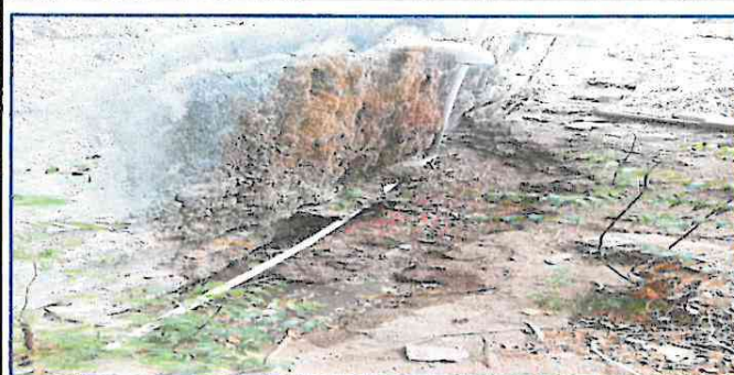
Foto 8: En la parte posterior de la cocina se evidencia la falta de una valvula para el drenaje de la pila.
