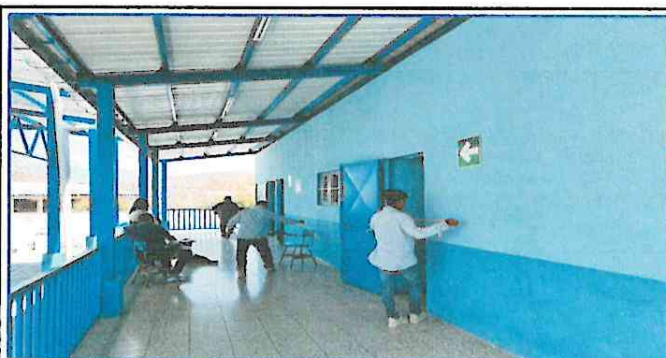
Foto 4: Los muros de las aulas necesitan nueva capa de pintura para su protección.
