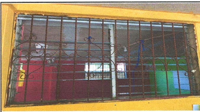
Foto 4: Desgaste de pintura de los balcones metálicos, y deterioro de las persianas de vidrios, las cuales están incompletas por quebraduras de los vidrios.
