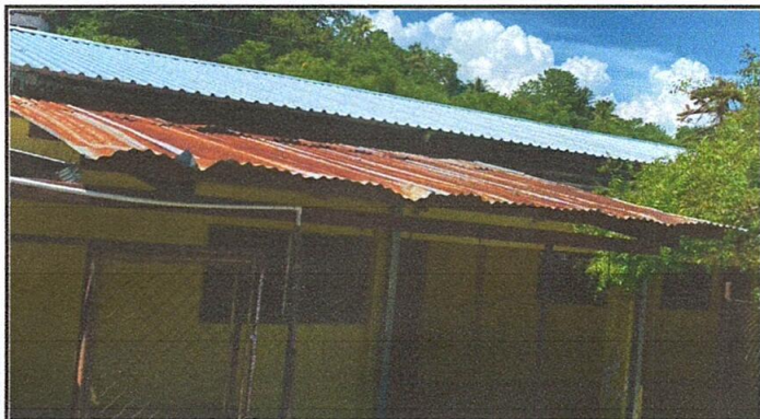
Foto 7: Lámina del comedor escolar en mal estado, presenta bastante oxidación.
