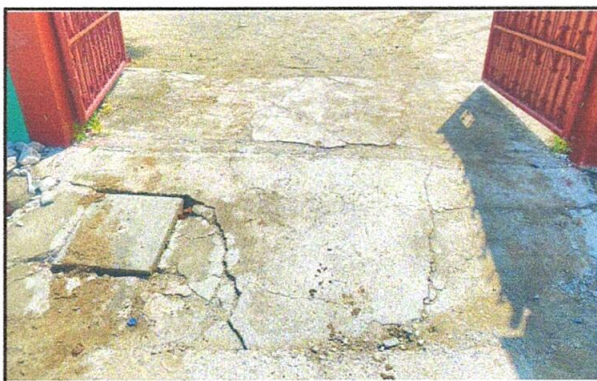
Foto 10: Grietas en concreto de la entrada principal de la escuela primaria, la cual se quiere reforzar para que soporte el peso del camión del tren de aseó.
