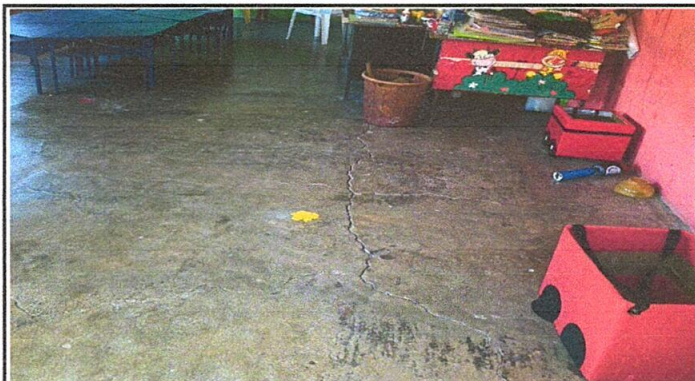
Foto 1: Estado actual del piso de aula 1, presenta varias grietas y deformaciones que generan desnivelación en el piso.
