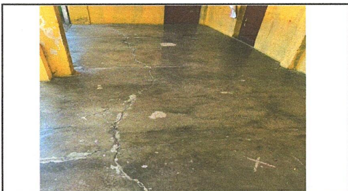
Foto 3: Estado actual del piso del corredor, presenta varias grietas y deformaciones que generan desnivelación en el piso.
