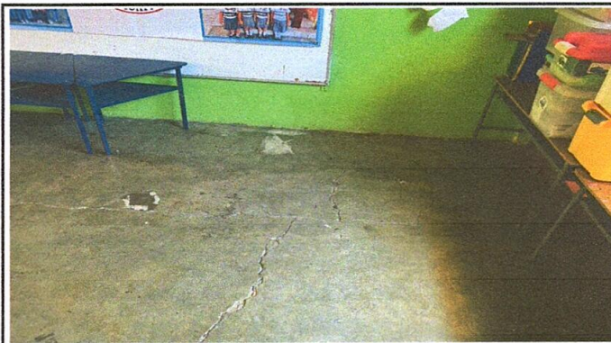
Foto 2: Estado actual del piso de aula 2, presenta varias grietas y deformaciones que generan desnivelación en el piso.
