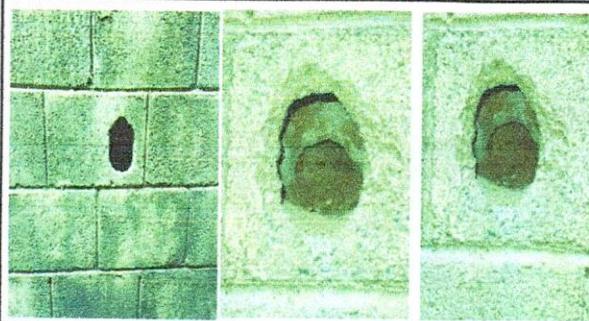
Foto 10: EL MURO YA CUENTA CON UNA SERIE DE ESTOS AGUJEROS SE DEDUCE QUE ES POR EL DETERIORO DE LOS MISMOS
