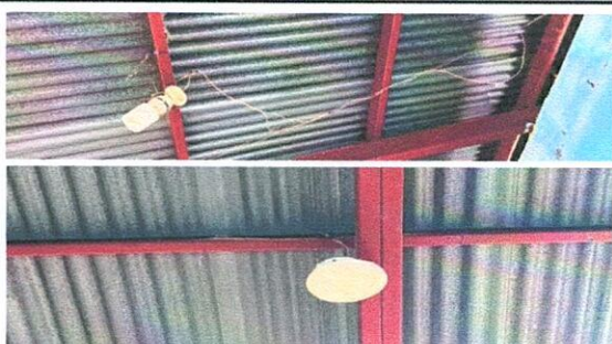
Foto 15: SUSTITUCIÓN DE LAMPARAS LED / SUSTITUCIÓN DE PLAFONERAS / CAJAS OCTAGONALES PARA REGISTRO (Las lamparas se encuentran quemadas y mal instaladas).
