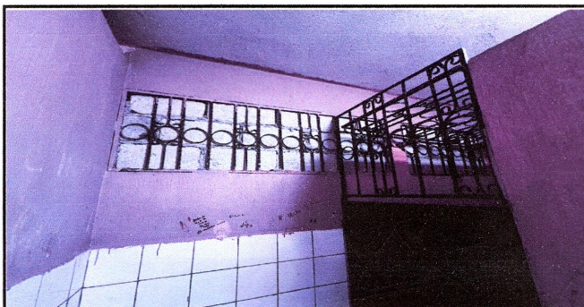
Repello y cernido en balcones sellados (se va quitar el balcon)
