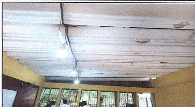
Foto 1: Aula en modulo 1, sustitución eléctrica por falta de iluminadad en el aula y deterioro de la misma.
