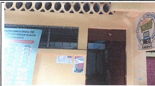
Foto 2: Dirección, en modulo 1, sustitución eléctrica por falta de iluminadad y deterioro de la misma.
