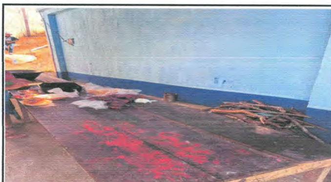
Foto 3: Mesa de Madera en Mal estado (Renglon 8.2 MESON DE CONCRETO)
