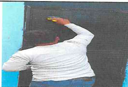
Foto 6: Pintura en puerta de aula
