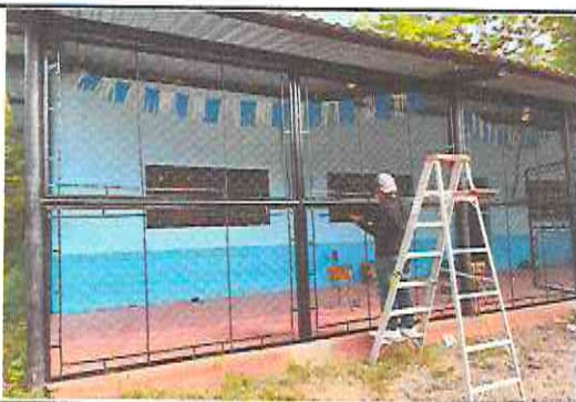
Foto 3: Mantenimiento de puerta de malla
