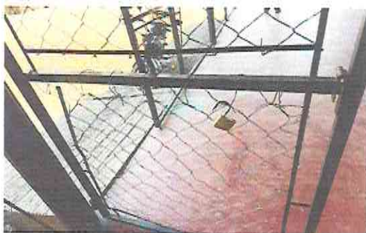
Foto 3: Mantenimiento de puerta de malla
