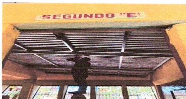
Foto 4: Así, luce el nuevo sistema instalado en el módulos de remozamiento
