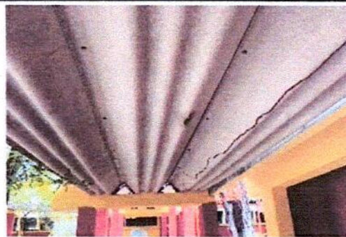
Foto 2: Se empezó a botar la Duralita del techo de un módulo que se encuentra enfrente del salón de conferencia
