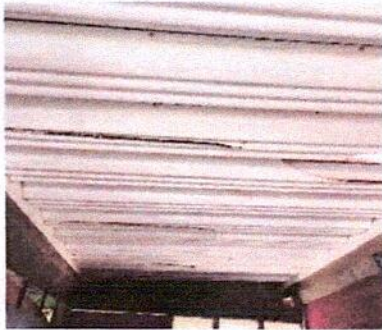
Foto 3: Continúan botando la duralita del techo un módulo del salón de clases del área de carpintería.
