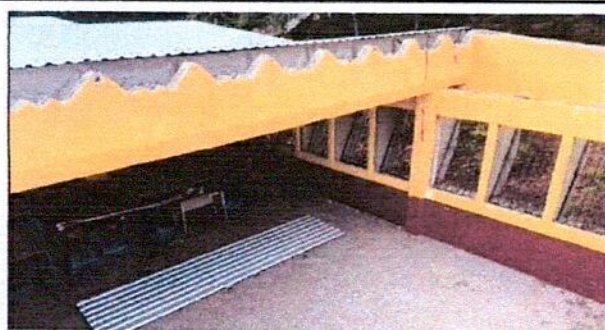
Foto 5: El módulo del salón de clases y pasillo Segundo Grado Sección E, sin lámina duralita
