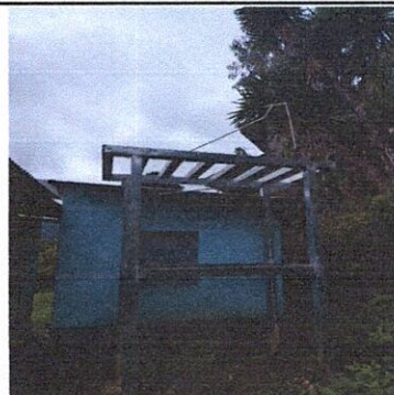
Foto 14: En la Presente fotografía se puede observar la Ausencia de los 2 Cisternas de Agua que se plasman en la foto No. 13, pues los mismos fueron Robados de las Instalaciones de la Escuela
