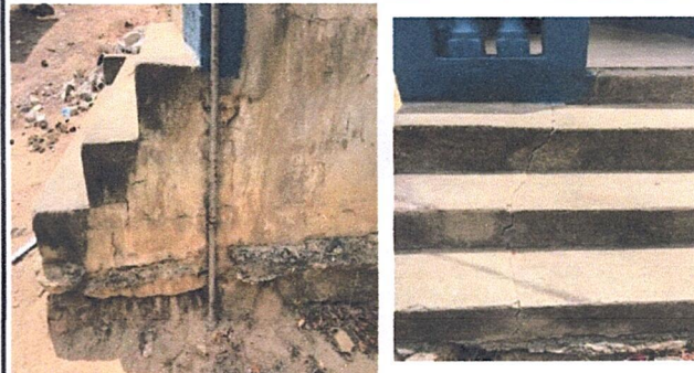
Foto 4: REPARACIÓN DE GRADAS, LOS DOS INGRESOS CUENTAN A LA ESCUELA CUENTAN CON GRADAS, PERO DEBIDO AL TIEMPO ESTAS SE HAN QUEBRADO Y RAJADO SIENDO TAMBIEN ESCARBADO EL SUELO POR EL DESNIVEL DE LA ESCUELA Y LAS FUERTES LLUVIAS
