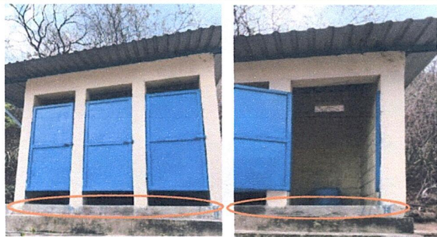
Foto 1: MANTENIMIENTO A PUERTAS DE BAÑOS (SE AMPLIARÁ LA ALTURA DE LAS PUERTAS, YA QUE LOS BAÑOS SE ENCUENTRAN EN UN LUGAR ALTO Y LOS ALUMNOS NO TIENEN LA PRIVACIDAD NECESARIA AL HACER SUS NECESIDADES /SUSTITUCIÓN DE PISO DE CEMENTO A PISO CERÁMICO EN BAÑOS. (El piso actual es torta de cemento como se ve en la fotografía).
