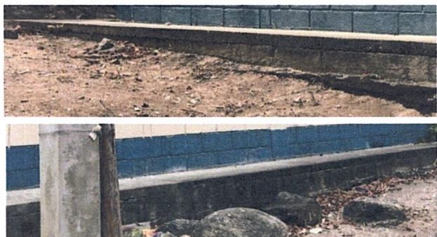
Foto 3: SE REALIZARÁ LA SUSTITUCIÓN DE LA BANQUETA DEBIDO A QUE EL BLOCK YA NO CUENTA CON LA CONSISTENCIA NECESARIA DEBIDO A EXPOSICIÓN DE LA LLUVIA LA CUAL HA MINIMIZADO LA FUERZA DEL MISMO, SIENDO UN TERRENO DESNIVELADO HA PROVOCADO LA EXCAVACIÓN DE LA MISMA.
