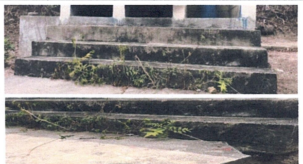
Foto 5: LAS GRADAS DE LOS BAÑOS SE ENCUENTRAN DETERIORADAS POR DENTRO DEBIDO A LAS LLUVIAS LAS CUALES HAN PROVOCADO LA PERDIDA DE SOLIDEZ EN LAS MISMAS.
