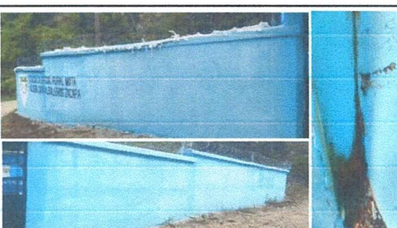
Foto 12: APLICACIÓN DE PINTURA EN MUROS INTERIORES Y EXTERIORES DE MUROS (Debido a las fuertes y constantes lluvias en la aldea la pintura se esta decolorando)
