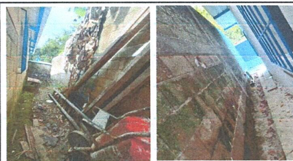
Foto 6: REPELLO Y CERNIDO EN MURO DE CORREDOR
