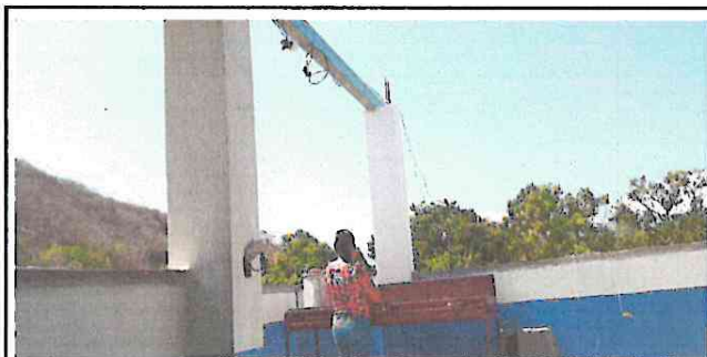
Foto 5: Sustrucción de ducto eléctrico + accesorios del area de cocina
