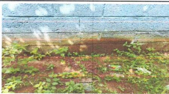
Foto 3: REPELLO GRIS EN PARED EXTERIOR DE AULAS (Se realizará el repello como medida de prevención para que no siga ingresando el agua pluvial en las aulas)
