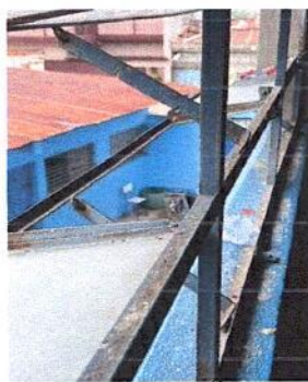
Foto 2: ESTRUCTURA VENTANA ( se desmontará toda la estructura para lijarlas, cepillarlas y pintarlas )
