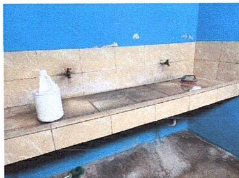
Foto 4: LAVAMANOS BAÑOS NIÑAS ( Se hará la demolición del lavamanos actual y se fabricará uno nuevo porque el actual presenta daños, resulta más factible sustituir que reparar )
