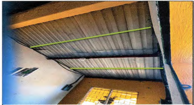
Numeral 2.1 Estructura de techo (Refuerzo para vigas) Numeral 3.1 (Lamina en mal estado "abollada y agrietada")
