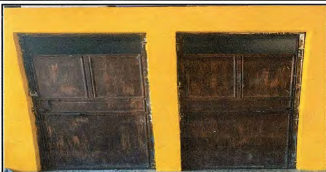
Numeral 7.2 Modificación a puerta de metal de sanitarios
