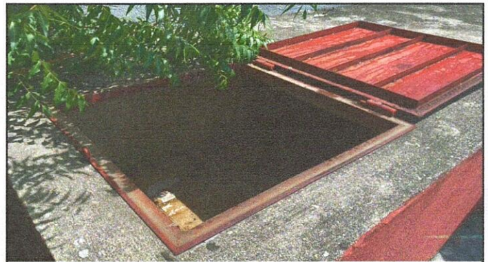
Foto 4: Tanque de agua potable en mal estado, presenta grietas y fuga de agua, por lo que esta fuera de uso, en su defecto se están utilizando dos tinacos para el almacenamiento de agua.
