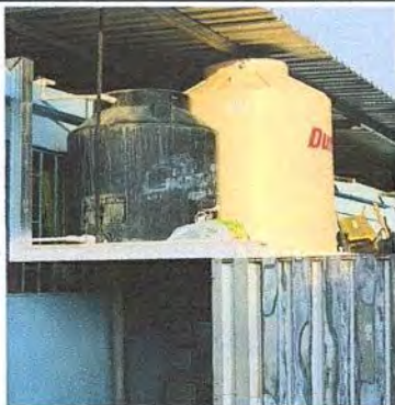
Foto 13: Conexión de Rotoplas hacia tubería (con accesorios) baño 2.2
