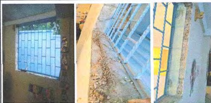
Foto 2: tallar ventana ya que se encuentra desnivelada y sin repello
