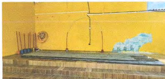
Foto 16: reparacion de cernidos mal aplicados 7.1
