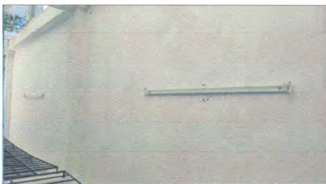
Foto 10: Sustitución de lámparas tipo tubo led
