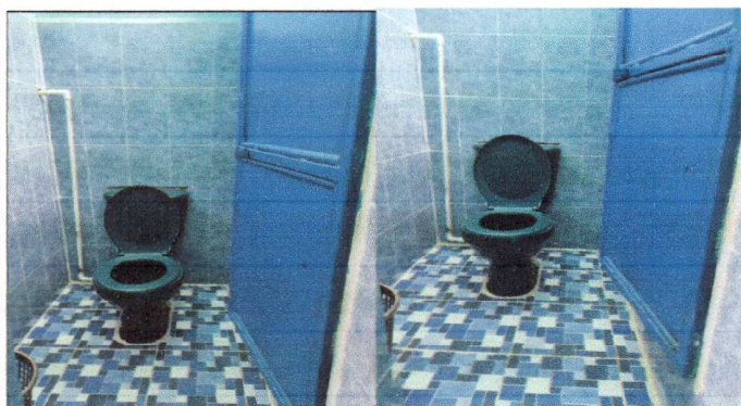
Foto 3: Servicios sanitarios y sus accesorios: Reemplazamiento de tazas sanitarias por mal estado
