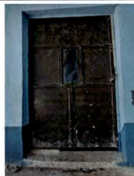
Foto 2: La parte de abajo lo tienen cortado por lo mal estado que ya esta.
