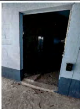
Foto 1: Es la puerta en el baño ya esta picado.
