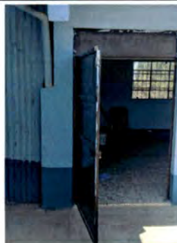
Foto 4: Se cambia de direccion de la puera 2 se arruina por el aire lo tira a la pared.
