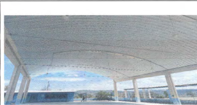
Foto 4: proteccion de lamparas platico, sustitucion por metal.
