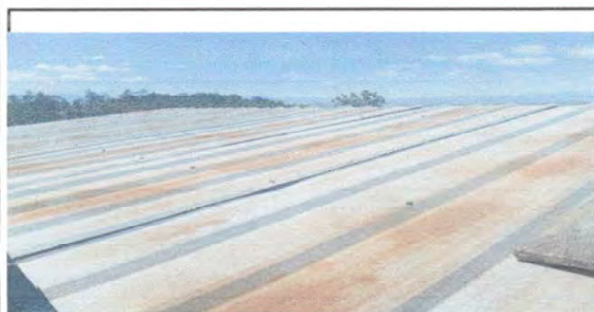
Foto 5: lamina deteriorado de los baños y capotes
