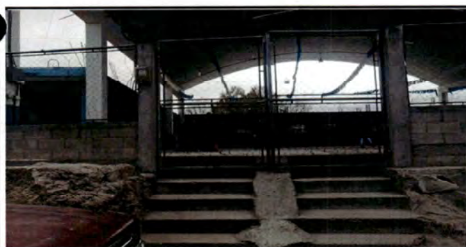
Foto 5: En esta fotografia refleja que es necesario la sustitucion de la puerta principal
