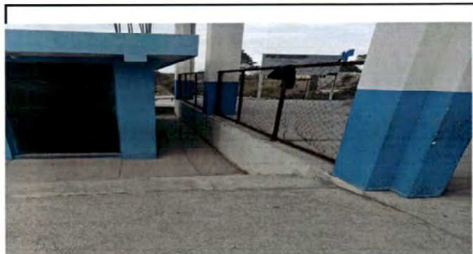
Foto 3: En esta fotografia demuetre que hay una grada en frente las aulas es por la misma razon en necesario colocar las barandas
