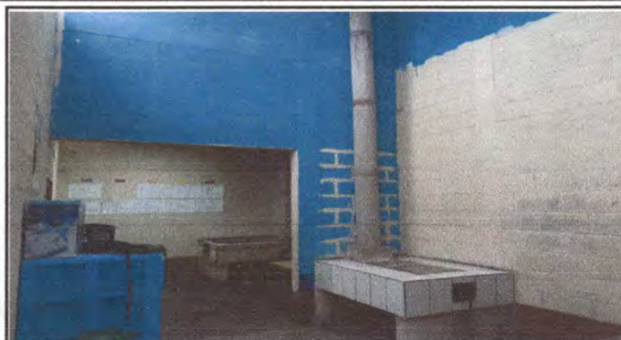
Foto7: Fachada de la cocina antes de la remodelacion de pintura.
