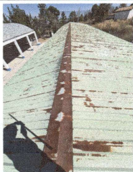
Foto 1: TECHO DEL ESTABLECIMIENTO EN MAL ESTADO, VISTA LATERAL
