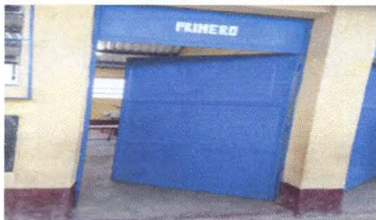
Foto 5: vista de mantenimiento y cortar la parte de abajo de puerta de primer grado. 10/03/2025
