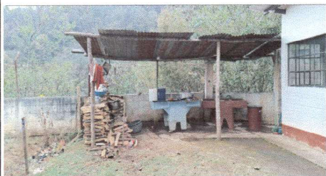
Foto 5: Sustrucción del techo de la galera a un costado de la cocina. (area de pila)
