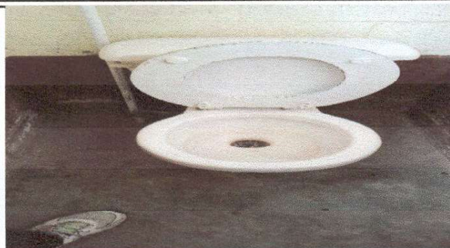
Foto 1: Sustrucción de 5 tazas estn obstruidos y se necesita su mejoramiento
