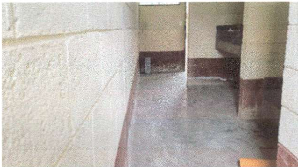
Foto 3: Sustrucción de pared baño por azulejos. ( Zócalo)
