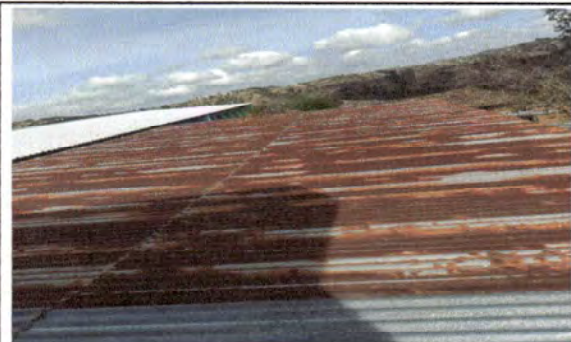
Foto 6: el techo de lámina de una de las aulas está relativamente caducada por lo que se cambiará incluyendo su base de madera a metal
