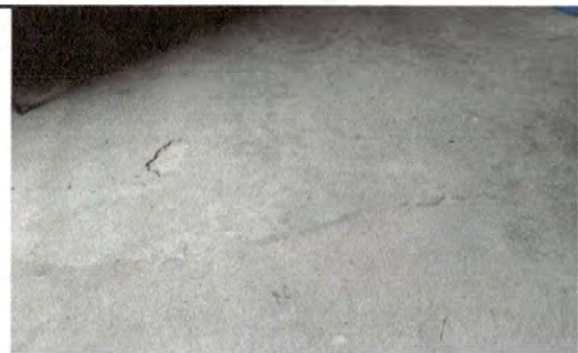
Foto 4: en una de las aulas el piso está realmente dañado por lo que se optó por colocarle piso de granito.
