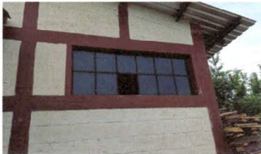
Foto 1: Ventana de cocina a cambiar debido a que no tiene ninguna puerta por lo que se encierra calor al cocinar
