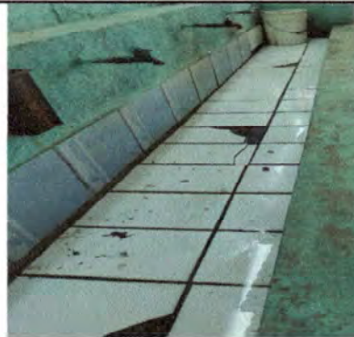
Foto 8: se requiere el cambio de azulejos en lavamanos
