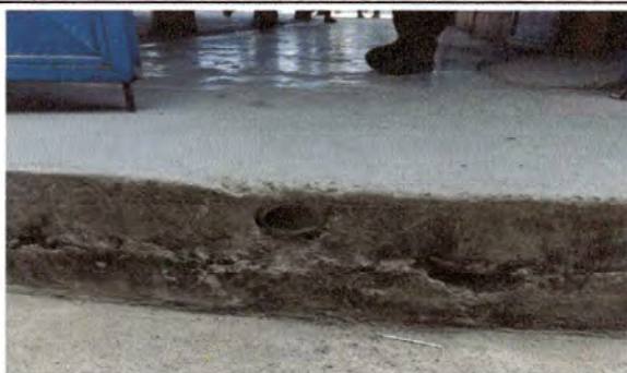
Foto 5: la salida de canales y bajada de agua es muy reducida que causa inundaion en el patio de la escuela, se desea ampliar la misma
