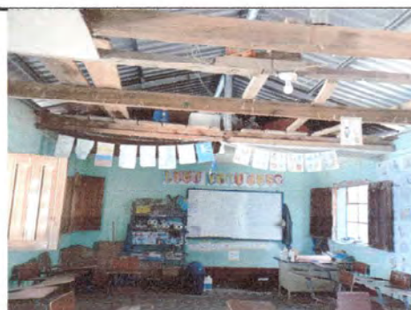
Foto 6: Pintura en las paredes se encuentra en mal estado.
