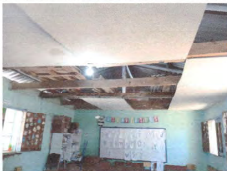
Foto 1: Se observa el estado actual de las aulas con cielo falso en mal estado (aula 1)
