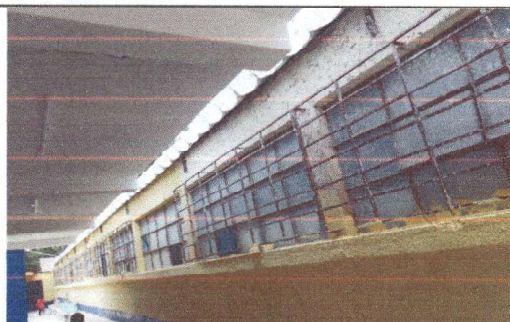
Foto 3: Ventanas en las estado con vidrios quebrados y sin vidrios, valones oxidados y en mal estado.
