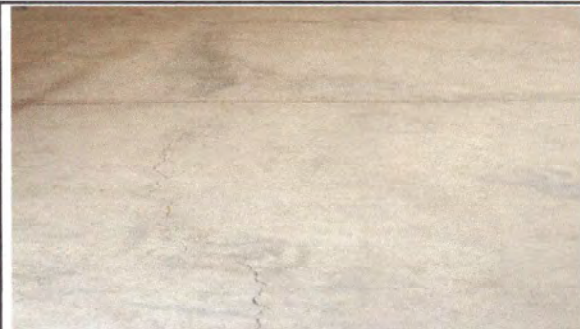
piso engrietado en varios puntos de bodega, sustitucion a piso ceramica.
