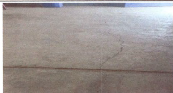
piso agrietado de la direccion, sustituido de piso ceramica
