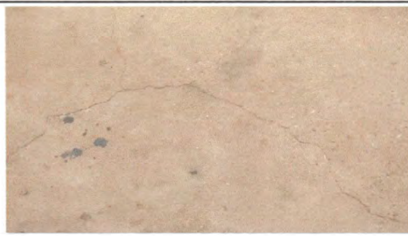
piso engrietado en varios puntos de cocina, en sustitucion a piso ceramico.
