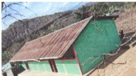
Foto1: Cambio de laminas 4 aulas de mal estado oxidado y gotea mucho de agua a tiempo de lluvia.
