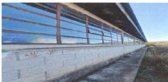
Foto 7: Pintada 4 aula de la escuela por que nunca se ha pintado.
