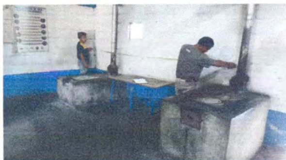
Foto 3: Cambio de dos Plancha de Cocina, por que esta mal estado
