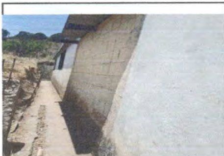
Foto 13: Por tiempos esta detoriando la pintura exterior de las aulas
