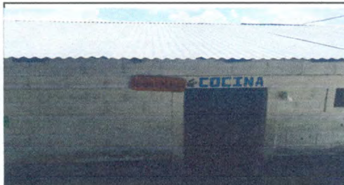
Foto 4: Por mal estado el techo de la cocina y la pintada de la concina
