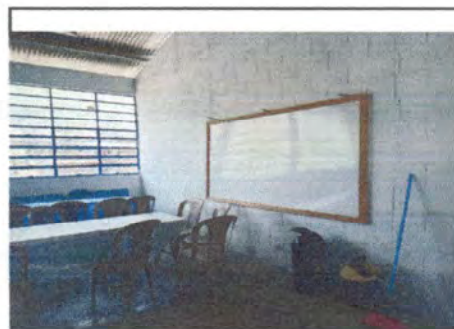
Foto 12: Por deterior de pintura del aula 6
