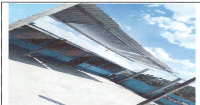
Foto 3: Techo de escenario que será remozado en estructura y techo. Vista desde corredor.
