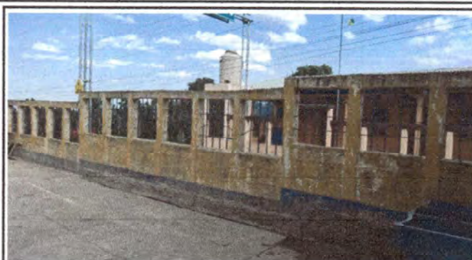
Foto 2: Vista de las barandas a sustituir, por barandas espaciadas a 12 cm, entre si y en su 90% verticales con algunor adornos de por medio.
