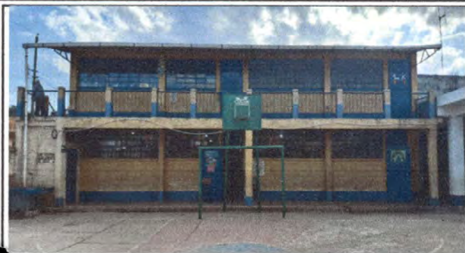
Foto 1: Sustitución de pintura exterior, incluye suministro y materiales (8 cubetas de pinturas comex, acrílico y 4 de aceite, 25 brochas), canal de PVC frontal y trasero por canal galvanizado, mantenimiento, pintada de
