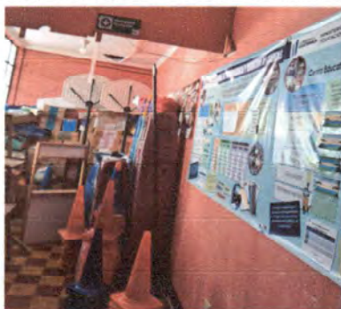
Foto 3: imagen de la estructura de tablayeso la cual por la fragilidad y el deterioro necesita sustitución.
