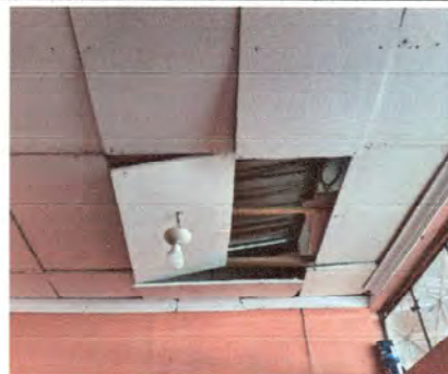
Foto 4: imagen del deterioro de la estructura del cielo falso en la cual incluso hay partes faltantes por el deterioro de las mismas.
