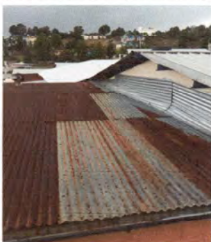
Foto 1: imagen del estado del techo de la bodega y la filtración de agua en época de invierno.
