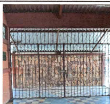
Foto 6: imagen del estado del portón, el cual es muy frágil y debe de ser reemplazado, ya que es una necesidad urgente.
