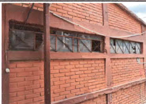
Foto 5: imagen del estado de los vidrios, los cuales deben de ser reemplazados de manera inmediata, por el polvo y mal estado en que se encuentran.
