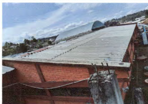
Foto 2: imagen del techo de los servicios sanitarios, se nota el deterioro y agujeros donde filtra el agua en época de invierno.
