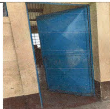
Foto 4: Fotografía de puerta de aula de mantenimiento a estructura.
