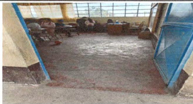
Foto 1: En esta fotografía se muestra el mal estado del piso de las aulas.
