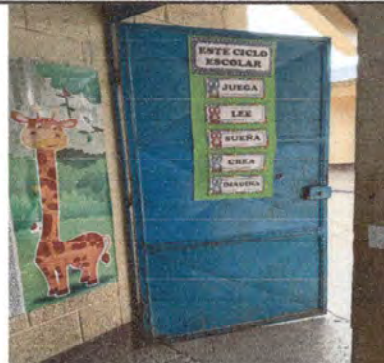
Foto 2: En esta fotografía se muestra la puerta que se va a sustituir.
