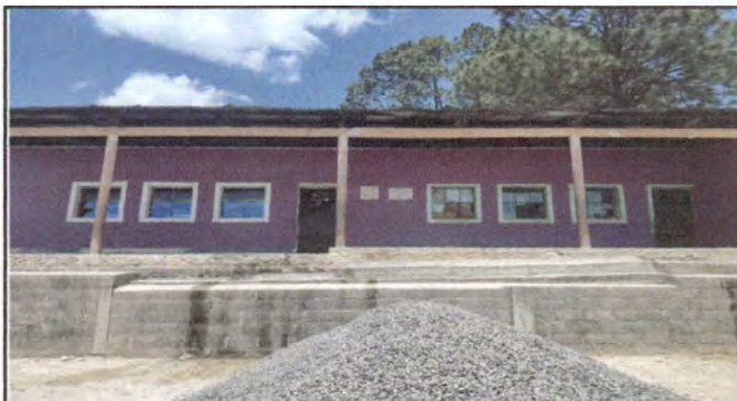
Foto 4: varanda que iran en cada poste del corredor para las tres aulas para proteger la integridad fisica de los alumnos
