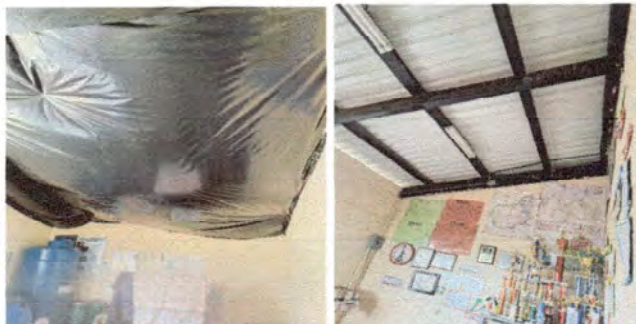
Foto 1: Vista de cubierta de techo en bodega y dirección. Ingreso de polvo y roedores. Colocación de machimbre en bodega y dirección en total 33 metros cuadrados
