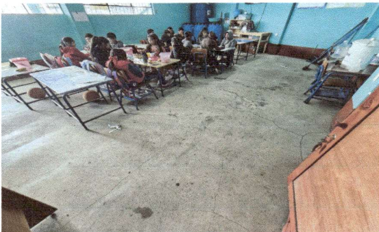
Foto 3: Vista del aula de quinto primaria, con el piso de torta de cemento en mal estado.
