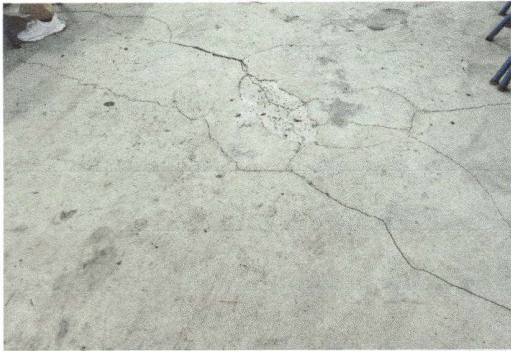
Foto 1: Vista del aula de quinto primaria, con el piso de torta de cemento en mal estado.
