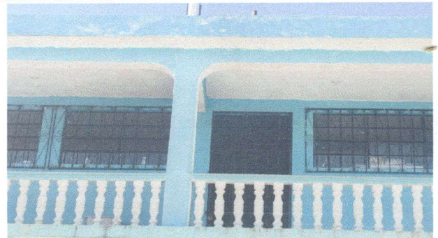
Foto 2: Vista en parte frontal del edificio escolar con la pintura en mal estado.
