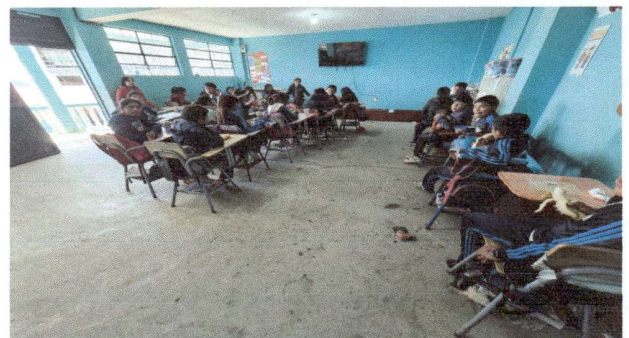
Foto 4: Vista en el aula de sexto primaria, con el piso de torta de cemento en mal estado.
