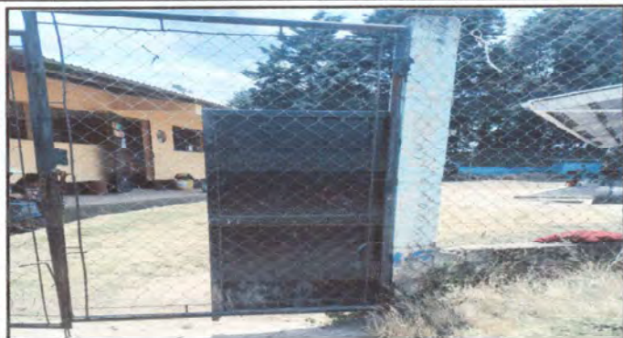
Foto 1: Sustrucción de Puerta de Entrada Principal: La puerta principal del establecimiento presenta dificultades, pues no cuenta con mayor soporte, lo que hace que no abra y cierre correctamente. Al mismo tiempo, es insegura por el tiempo de desgaste.
