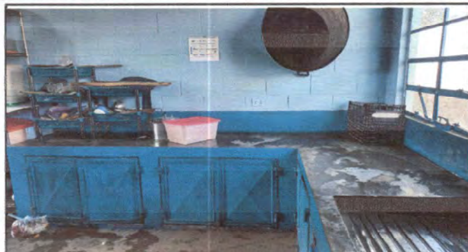
Foto 8. Colocación de azulejo de comedor: El comedor no cuenta con azulejo para poder preparar adecuadamente los alimentos, por lo que es necesario modificar y colocar el mismo para mayor higiene.
