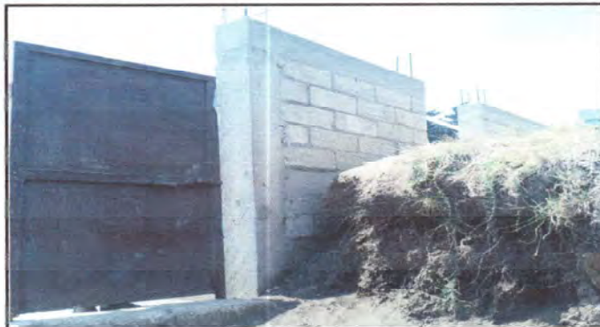
Foto 2: Sustrucción de Puerta de la Cancha del Establecimiento: La cancha cuenta con una puerta imprevista y usada, la cual no abarca con el espacio requerido y suele abrirse con facilidad debido a su avanzado uso.
