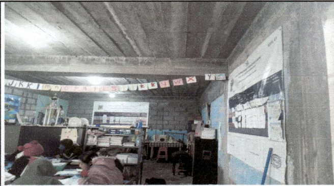
Foto1: Repellar el aula número uno ya que hace falta dicha acción en la misma y en el aula número dos.
