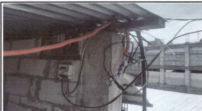
Foto 1: Cambio de contador y cometida desde el poste hacia la escuela ya que nos ha provocado corto circuitos siempre
