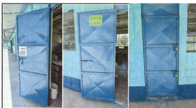
Foto 4: Vista de las puertas de los grados de cuarto "B", primero "A" Y "B" a pintar y darle mantenimiento, sustitucion de candados por chapas
