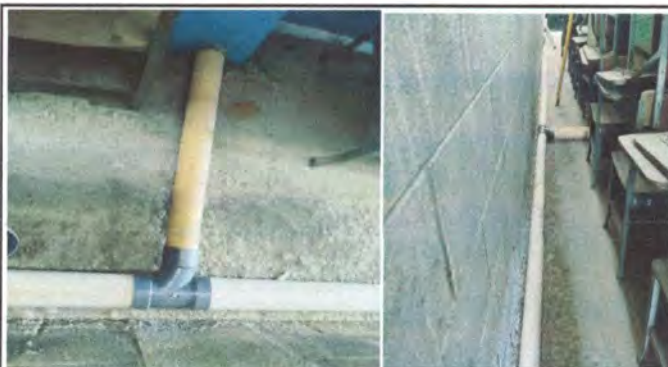
Foto 9: VISTA EN DONDE SE REALIZARÁ SUSTITUCIÓN DE TUBOS PARA DESFOGUE DE AGUA Y EXCAVACIÓN DE ZANJA
