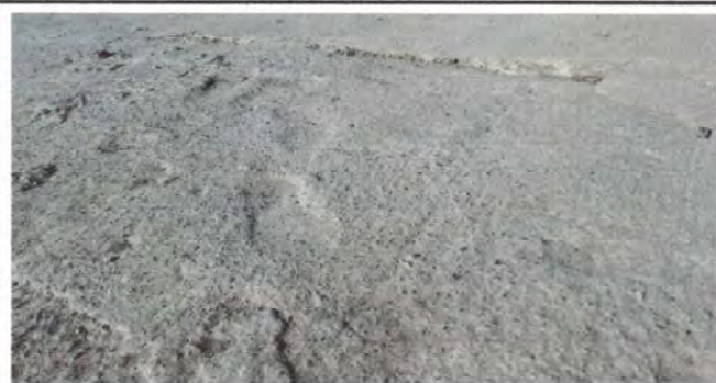
Foto 2: Deterioro de la losa de patio.
