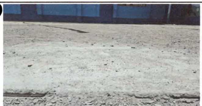
Foto 5: Vista frontal del patio y deterioro de la losa del patio.
