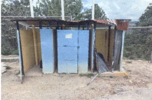
Foto 1: Sustrucción de techo de servicio sanitarios en mal estado
